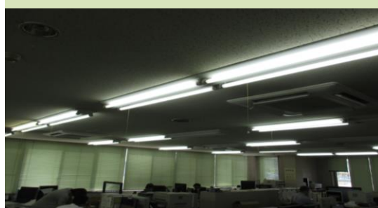
事務所内の照明間引き
